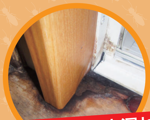
浴室・台所の水漏れ
