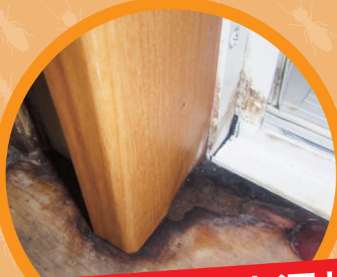
浴室・台所の水漏れ
