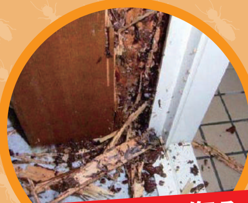
浴室桧木の傷み
